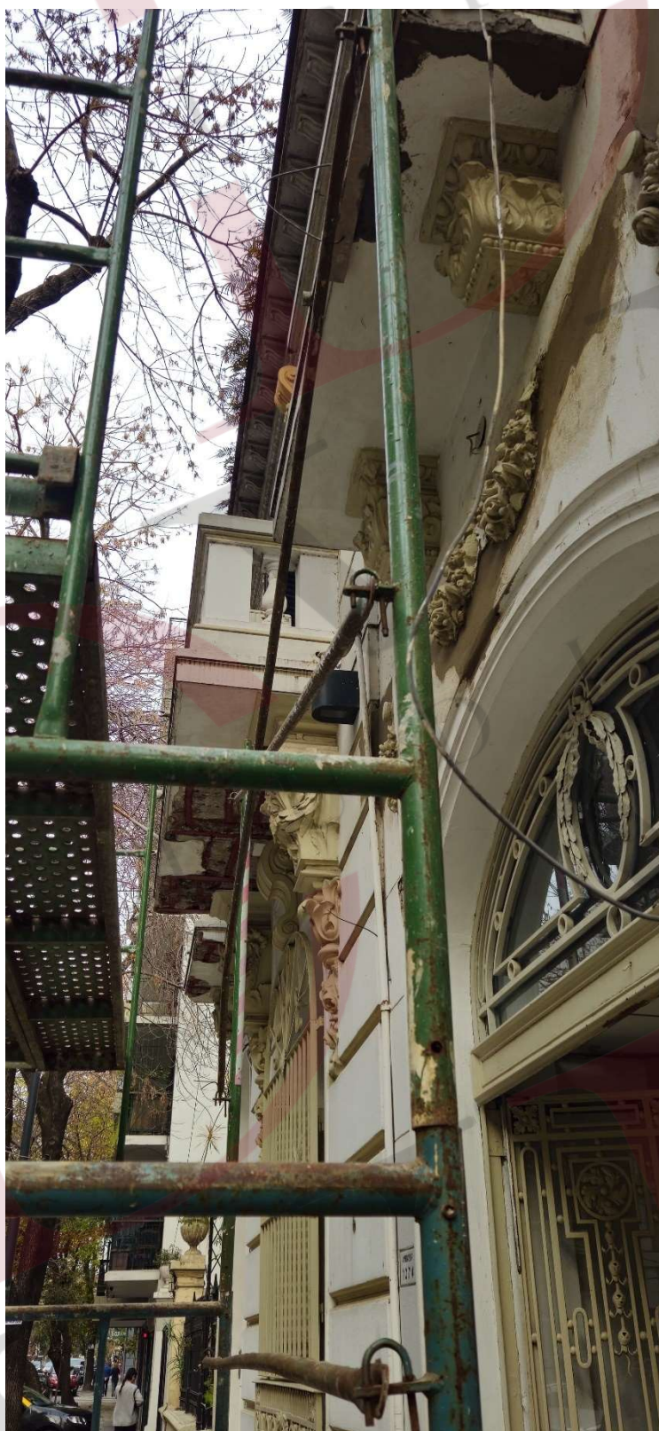
Imagen 2.12 – Fisura en balcones
