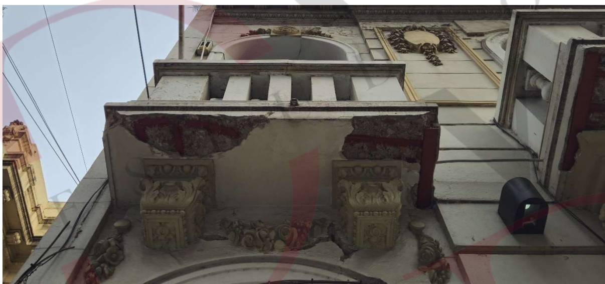
Imagen 2.11 – Fisura en balcones
